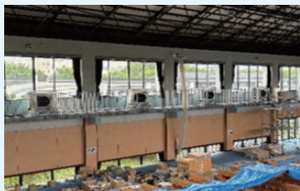
体育館空調機
