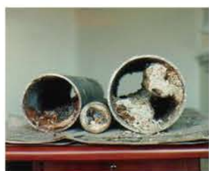
油脂によるつまり(屋内排水管)
