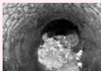
▲下水道管の中で固まった油
