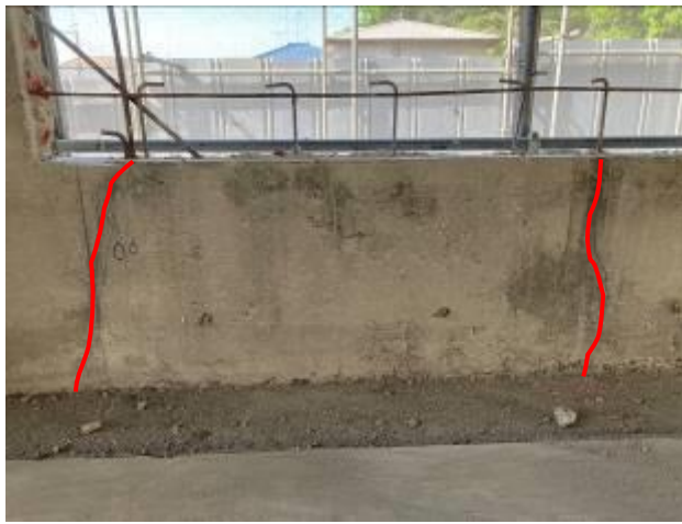
既存東棟1階壁クラック
