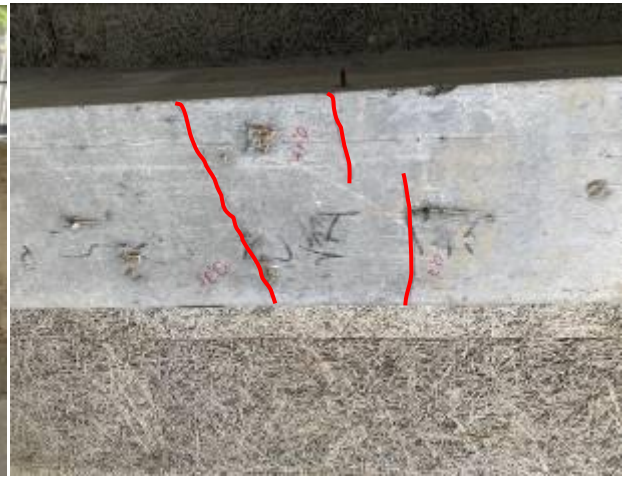
既存西棟2階梁クラック
