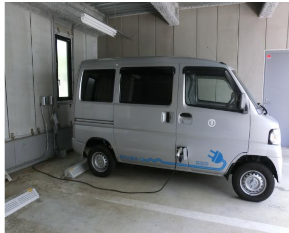
庁舎車庫・倉庫棟内充電設備
