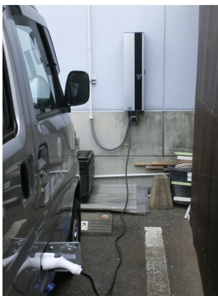
リサイクルプラザ充電設備
