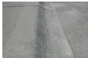
屋上面の劣化
