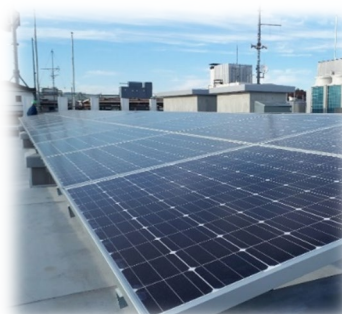
■ 太陽光発電設備（役場庁舎） ■
