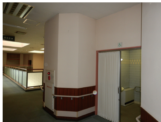
建物 内壁 仕上塗材が使用されている部分 ※外観からは見られません。
