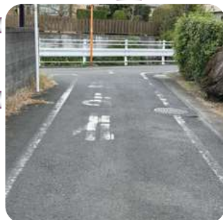
白線が消えかかっている道路
