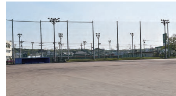
町営グラウンドのナイター設備
