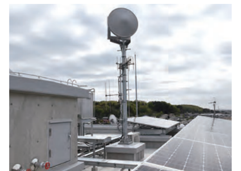
新庁舎屋上に移設された都の防災行政無線
