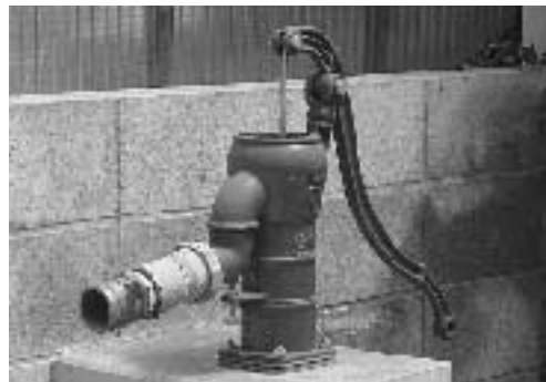
六道山の石畑給水所に設置されている手押しポンプ
