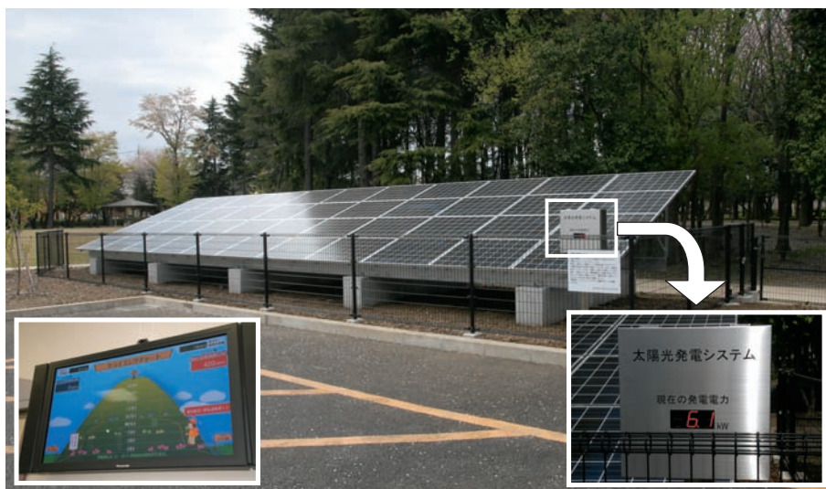
みずほリサイクルプラザに設置された太陽光発電システム
