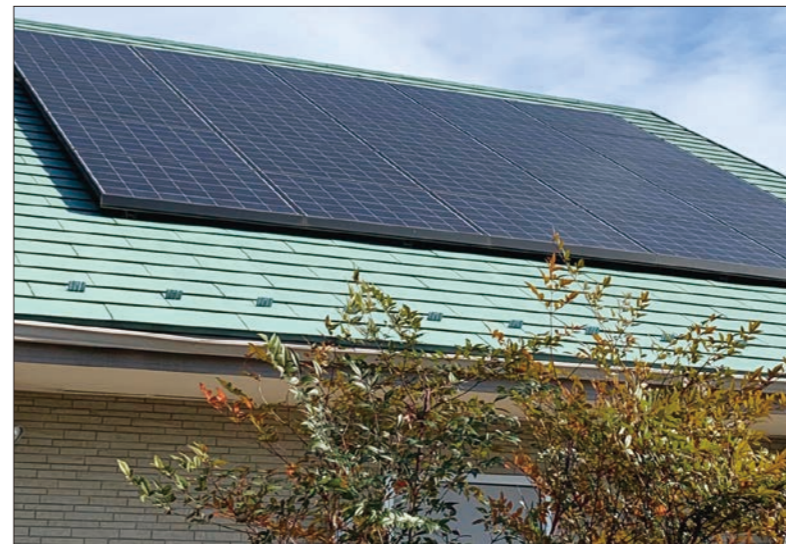
太陽光パネルが設置された住宅
