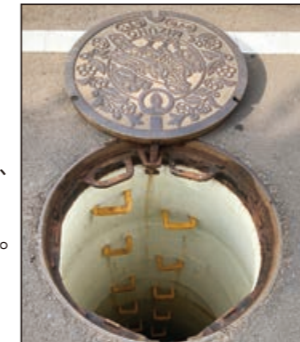
下水などの管渠を補修するための人孔（マンホール）
