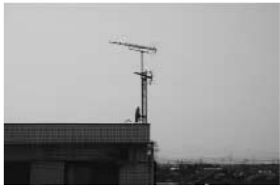
ビル屋上に設置された地上デジタルアンテナ
